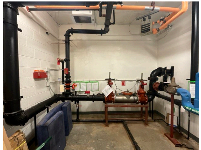
28 - FIRE SPRINKLER RISER
